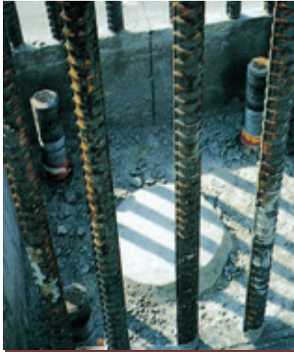
11. コンクリート打設後、形板を撤去しレベルモルタル作製
