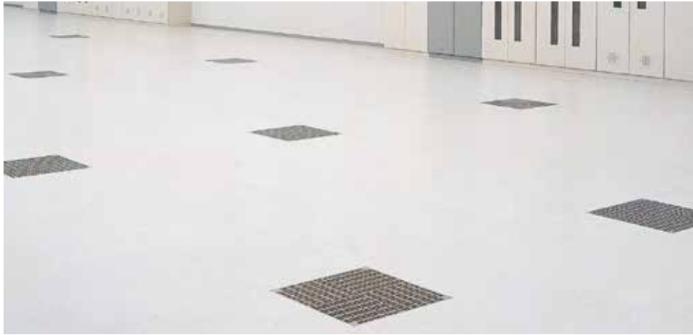
DC用フロアの施工例
